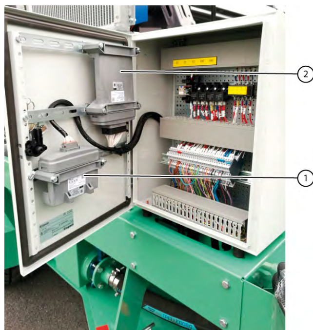
Fig. 111 Emplacement des contrôleurs
